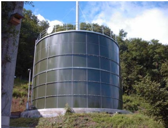
Biogasbehälter mit Gehäuse aus emaillierten Stahlblechplatten, die miteinander verschraubt sind
